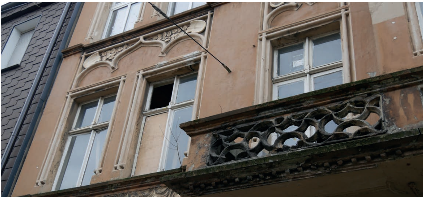
Abb. 8: Problemimmobilie aus der Gründerzeit in Gelsenkirchen
