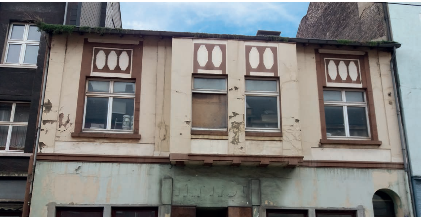
Abb. 36: Problemimmobilie in Duisburg-Marxloh
