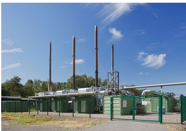
Bild 2.1 – Grubengasverwertungsanlage (Quelle: Friedhelm Krischer)
