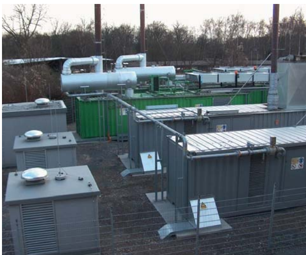
Bild 1.1 – Grubengasverwertungsanlage (Quelle: BR Arnsberg)
