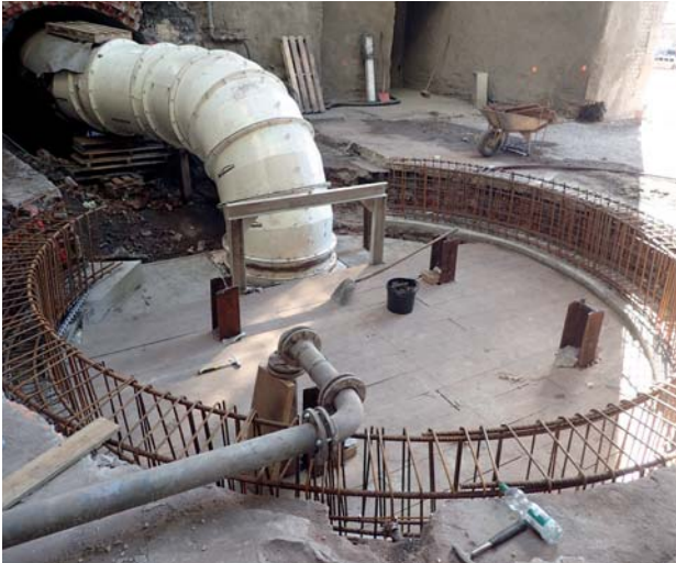
Bild 8.3 – Neue Schachtschutzbühne (Quelle: RAG Deutsche Steinkohle)
