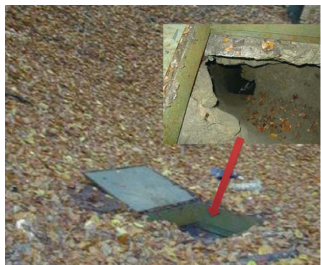
Bild 10.12 – wilde Grabung direkt in das Grubengebäude (Grube Porta)
