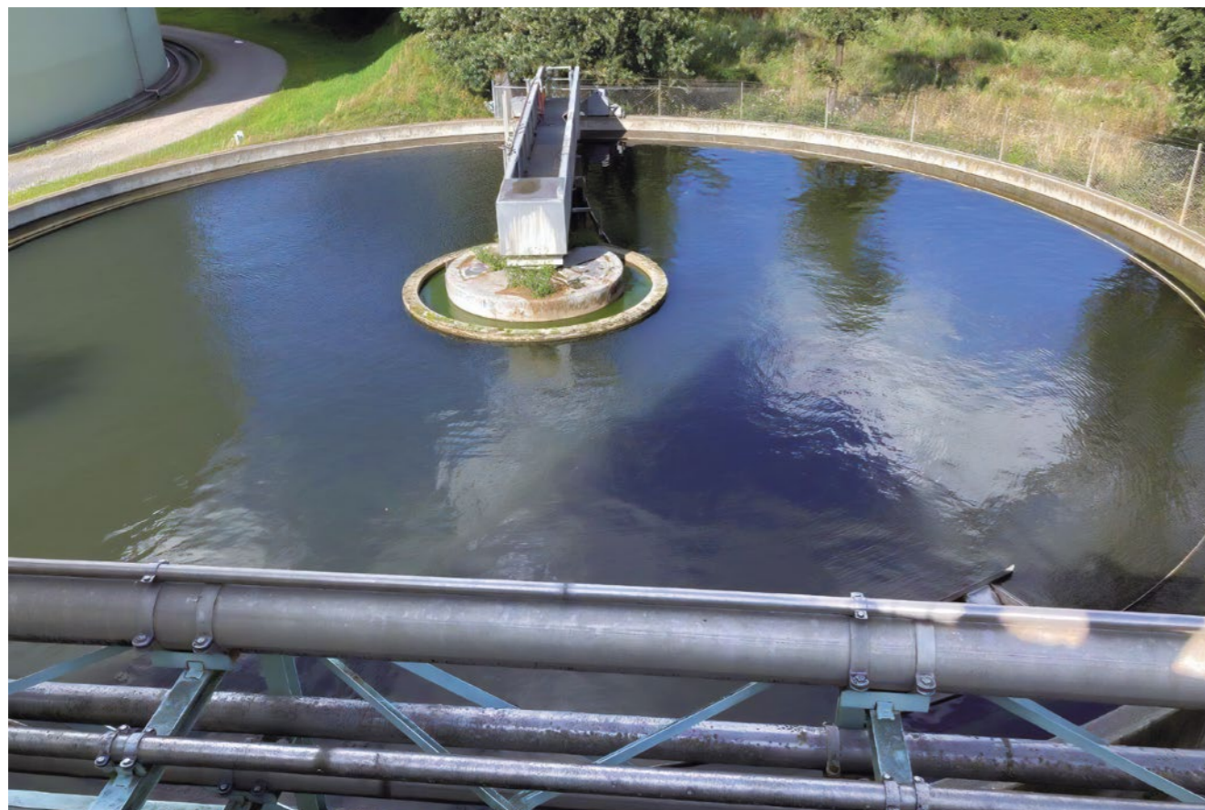
Rundes Nachklärbecken der Firma Pfeifer und Langen
