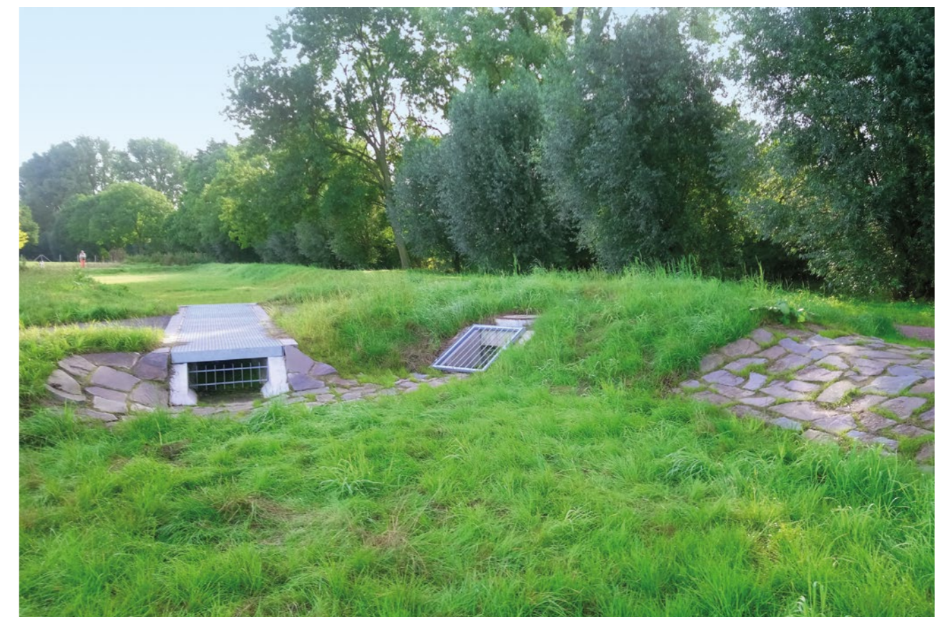
Zulauf zur Versickerungsmulde im Neubaugebiet Alter Angerbach in Duisburg
