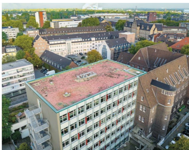
oben: „Fassadenbegrünung am Hauptbahnhof-Parkhaus in Bottrop. Land (KRiS) und Emschergenossenschaft haben die Bepflanzung der Wand mit rund 150.000 Euro gefördert. Ein 80 Quadratmeter großer grüner Pflanzenteppich schmückt seit 2022 die Südfassade des Parkhauses. Das Grün ist aber nicht nur ein ästhetischer Blickfang, es hat auch einen ganz konkreten Nutzen für das Mikroklima vor Ort: Die vertikale Vegetation sorgt über die Verdunstung ihrer Blätter für eine Kühlung der Umgebung und bindet Feinstaub.“
