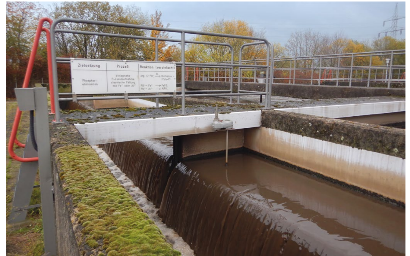
Biologische Phosphorelimination auf der Kläranlage Minden
