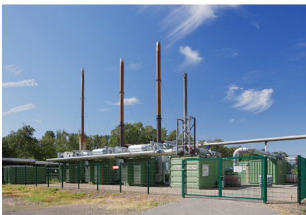
Bild 2.1 – Grubengasverwertungsanlage (Quelle: Friedhelm Krischer)
