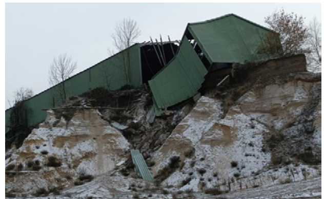
Bild 3.4 – Beschädigte Halle am unmittelbaren Rand der Erosionsrinne (Quelle: Bezirksregierung Arnsberg)
