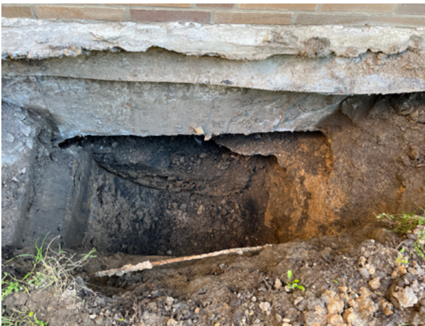
Bild 1.6 – Tagesbruchstelle direkt an der Außenwand der Schule (Quelle: Bezirksregierung Arnsberg)
