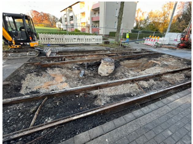
Bild 1.8 – Tagesbruch ausgekoffert, im Hintergrund rechts ein Bohrgerät für weitere Probebohrungen (Quelle: Bezirksregierung Arnsberg)
