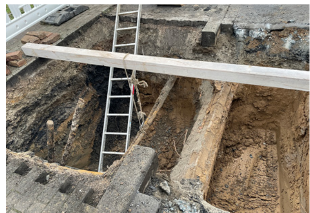
Bilder 12.8 – Eindrücke aus der Erkundungs- und Sicherungsmaßnahme Tagesbruch 1 (Quelle: Bezirksregierung Arnsberg)
