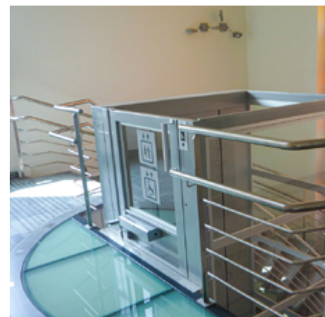
Oberer Ausstieg des Plattformaufzugs (Bild links) mit dem oben offenen Schacht
