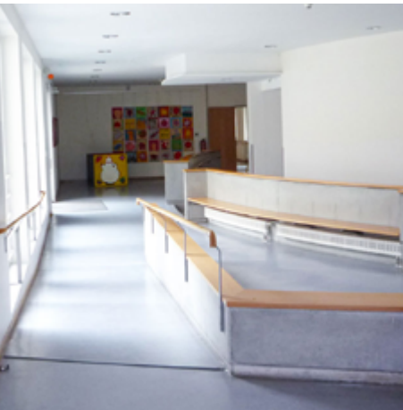
Barrierefreie Rampe in einer Schule. Die halbhohle Brüstung dient rückseitig als Sitzgelegenheit.
