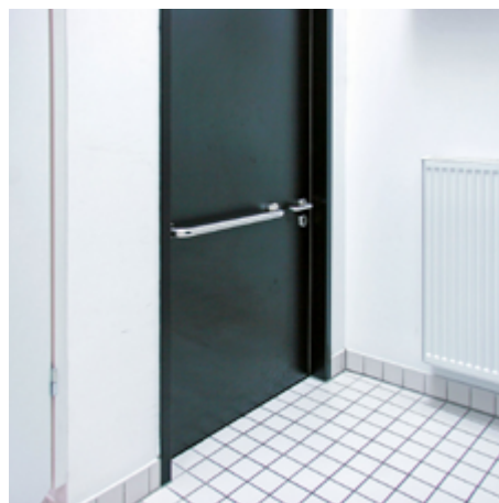
Zuziehstange auf der Innenseite einer WC-Tür (Der Türdrücker hat aber nicht 50 cm Mindestabstand zur Wand.)
