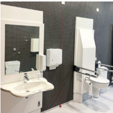
Waschtisch und Toilette elektrisch höhenverstellbar in einem kontrastreichen barrierefreien WC
