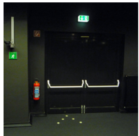
Fluchttür mit Panikriegel und nachleuchtenden Markierungspunkten in Fluchtrichtung auf dem Boden
