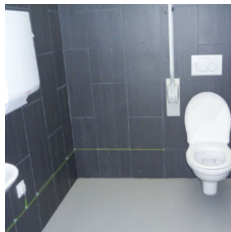
Horizontaler Notruf-Seilzug durch Ösen um die Ecke geführt; auf der linken Wand sitzt das Rufmodul
