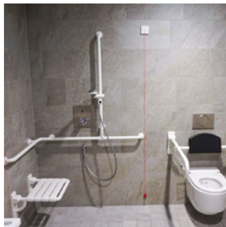
Die Position des langen Schlauchs ermöglicht die Nutzung der Dusche auf dem Klappsitz und dem WC.
