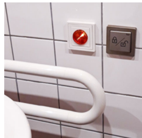
Barrierefreies WC mit Schalter für das elektrische Türschloss und roter Schließanzeige
