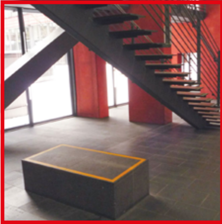
Diese Treppenstufen stellen eine große Gefahr für blinde Menschen dar. Sie sind seitlich nicht gesichert.
