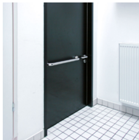
Waagerechte Zuziehstange an der Innenseite einer WC-Tür (aber Abstand zwischen Griff und Wand ist zu gering)
