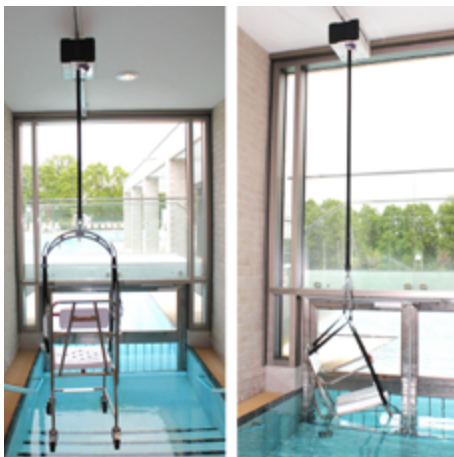
Lifter an einer Laufschiene für den barrierefreien Zugang zum Außenbecken
